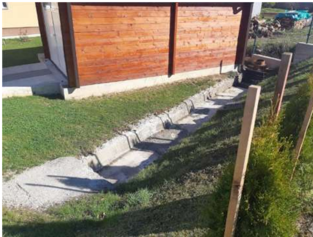
Slike 5 i 6: Kanal za pribrežne vode na uzvodnom i nizvodnom dijelu trase (nastavak kanala je uglavnom zatvoren ispod pristupnih puteva ka objektima)
